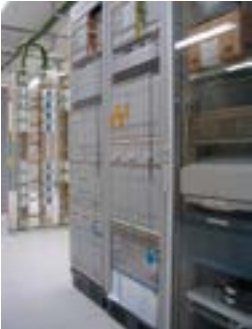
Aménagement de 19 centres de télécommunication en France pour Lambdanet, opérateur de réseaux à haut débit
